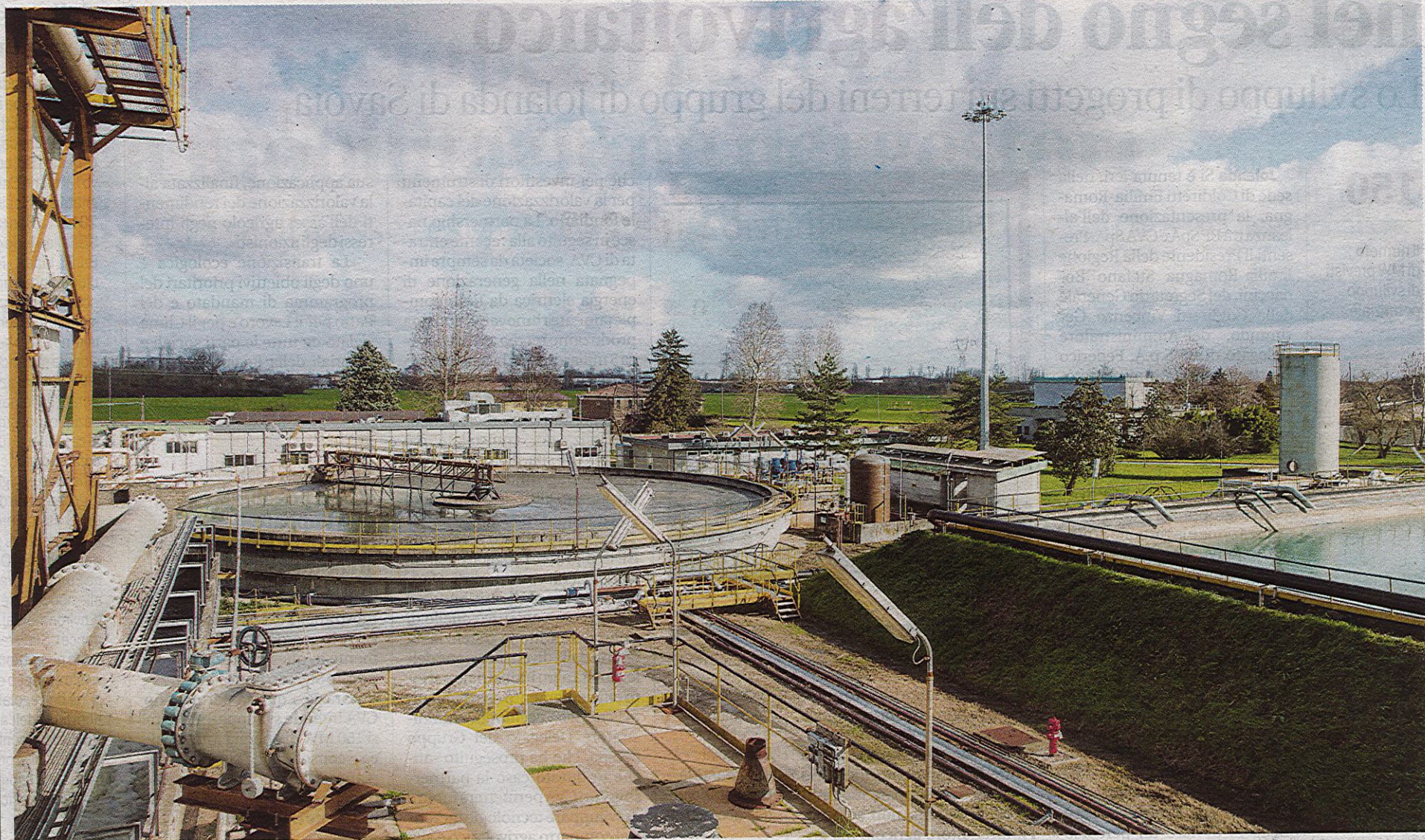
L'impianto Trattamento acque superficiali che dovrà essere implementato per ridurre i prelievi dal Po (foto Giori/Rubin)
